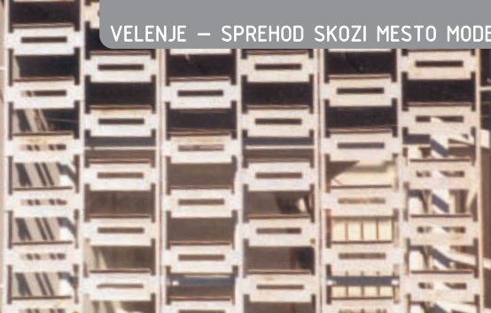
Hotel Paka: mreže na stopnišču (uničeno)
